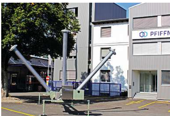
Eine Mobile Messstation, 3-Phasen RC-Teiler.
